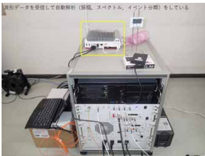
写真 1. リアルタイム処理システムの PC 筐体 (写真中の黄色四角). 光送受信装置のラックの天井面の上に PC がある。
